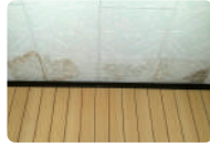
天井の雨漏り
