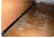
部屋の床の漏水
